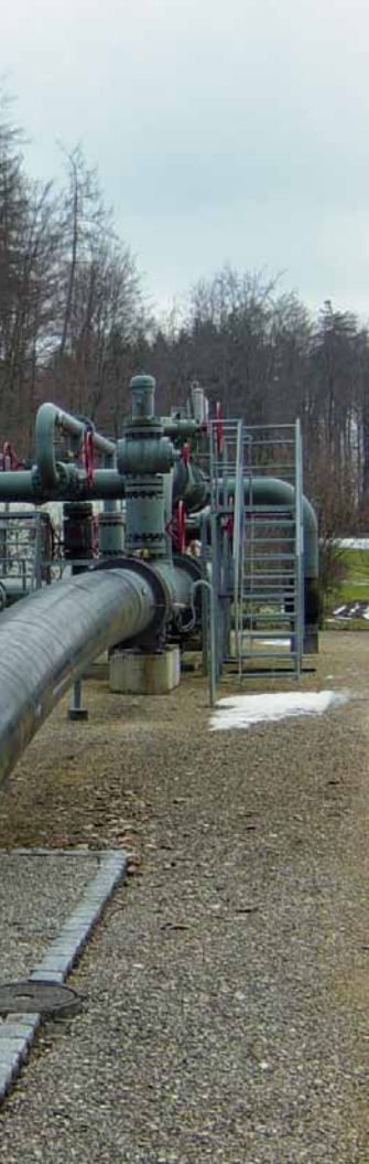
Abbildung oben: Druckreduzier- und Mess- station bei Altavilla (FR)
